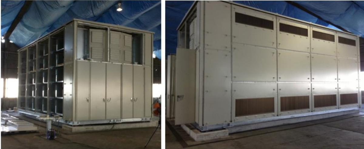
Figura 11 – Shelter dell'assemblato batterie NAS da 1,2 MW
