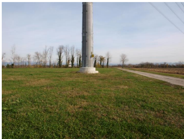
Figura 7 Intervento di ripristino ante-operam a prato sulla linea 380 kV Udine Ovest-Udine Sud
