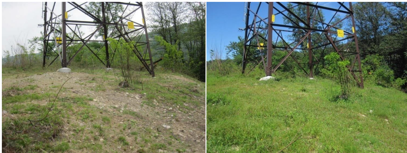
Figura 10 Interventi di rinaturazione ante e post operam sulle linee 132 kV della Val D'Ossola Sud
