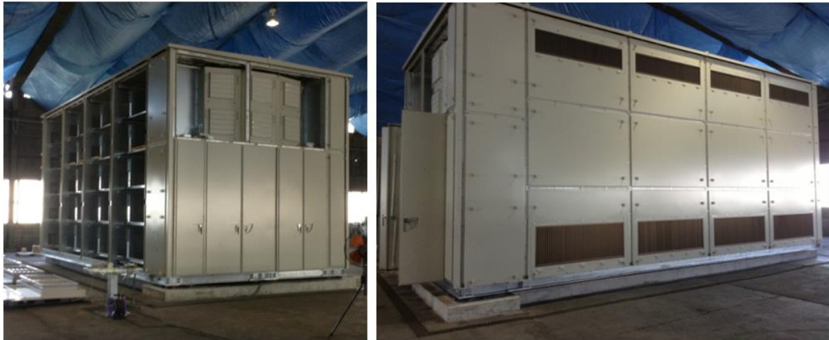
Figura 15 – Shelter dell'assemblato batterie NAS da 1,2 MW
